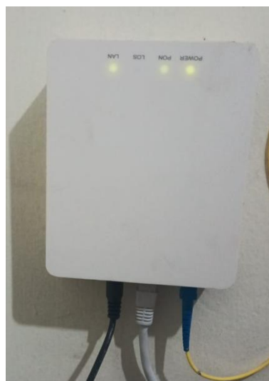
Imagen 20. ONU enganchada (PON activo)
