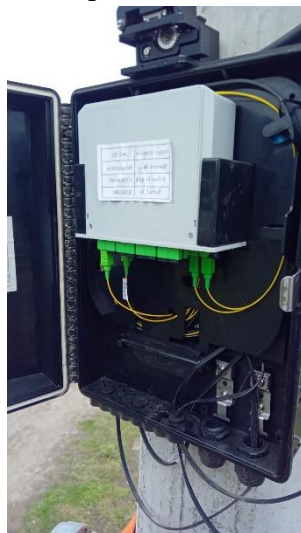
Imagen 4. Puertos libres en caja de distribución
