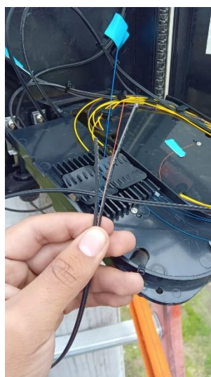
Imagen 5. Hilos de fibra óptica
