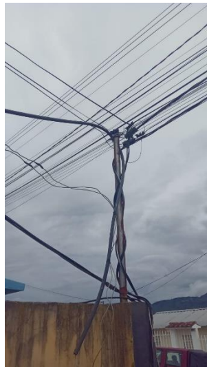
Imagen 13. Tubo de acometida eléctrica y telecomunicaciones
